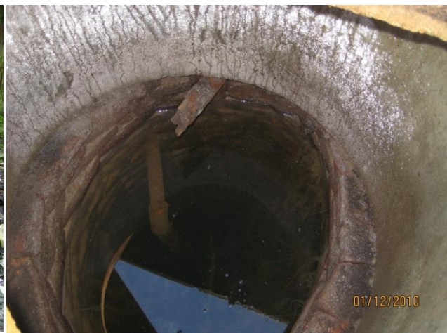
Risiko ved forureninger via inaktive brønde og borer
