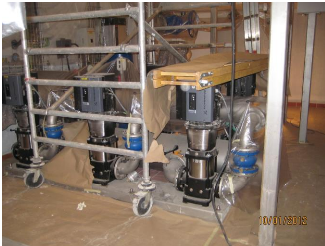
Risiko for forureninger i forbindelse med renoveringsarbejder på et vandværk
