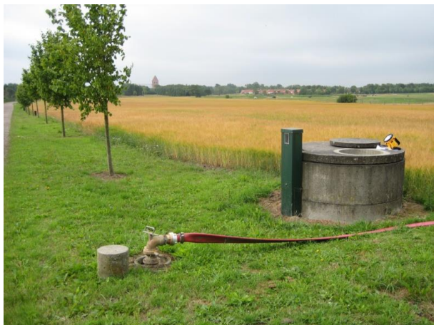
Markvandingsboring – risiko, hvis der ikke er monteret kontraventil til sikring af tilbageløb
