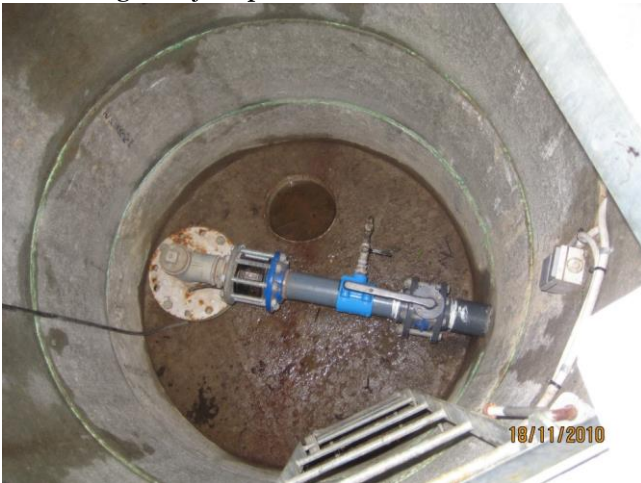
Indvindingsboring med tørbrønd – risiko for indsivning af overfladevand og opstigende grundvand
